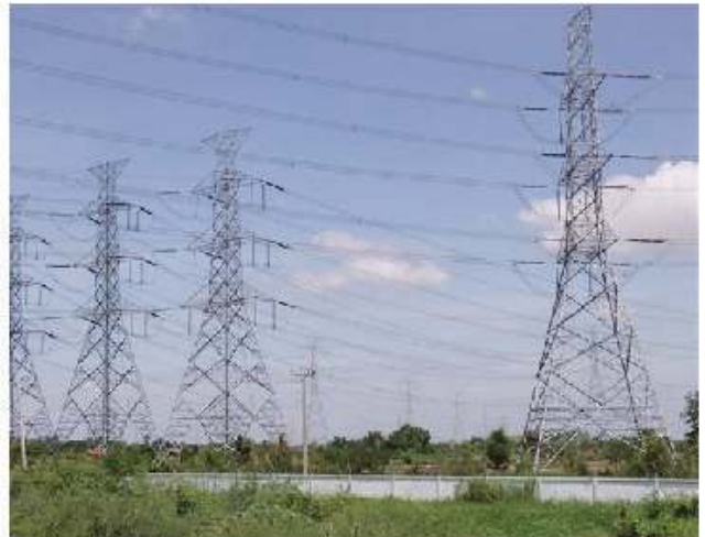
เสาไฟฟ้า
