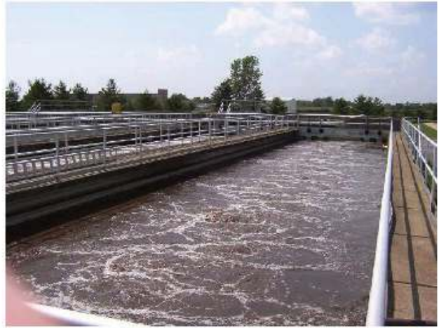
บ่อบำบัดน้ำเสีย
